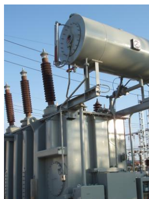
Figura 2.11: Transformador de potencia con depósito de expansión
