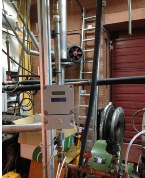
Fig. 6: Caudalímetro de aire en primer plano. Fuente: [1].
