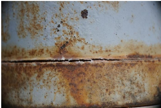
A) Crevice corrosion
