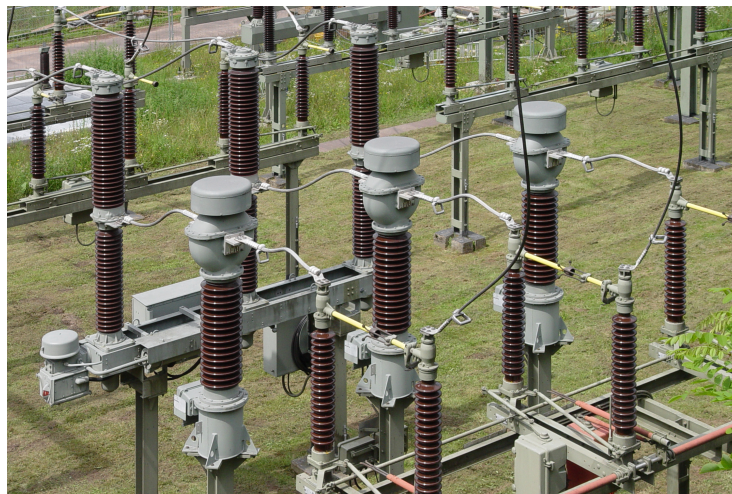
Figura 1: Posición de una subestación a 110 kV. En primer plano, seccionadores cerrados; detrás, transformadores de medida de intensidad; detrás, interruptores automáticos. Ver atribución en A.
