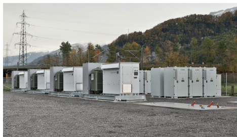
(b) Baterías en Walenstadt (Suiza).
