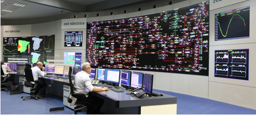
Figura 2: Centro de control eléctrico (Cecoe) de Red Eléctrica de España en Alcobendas, Madrid. Ver atribución de la imagen en A.
